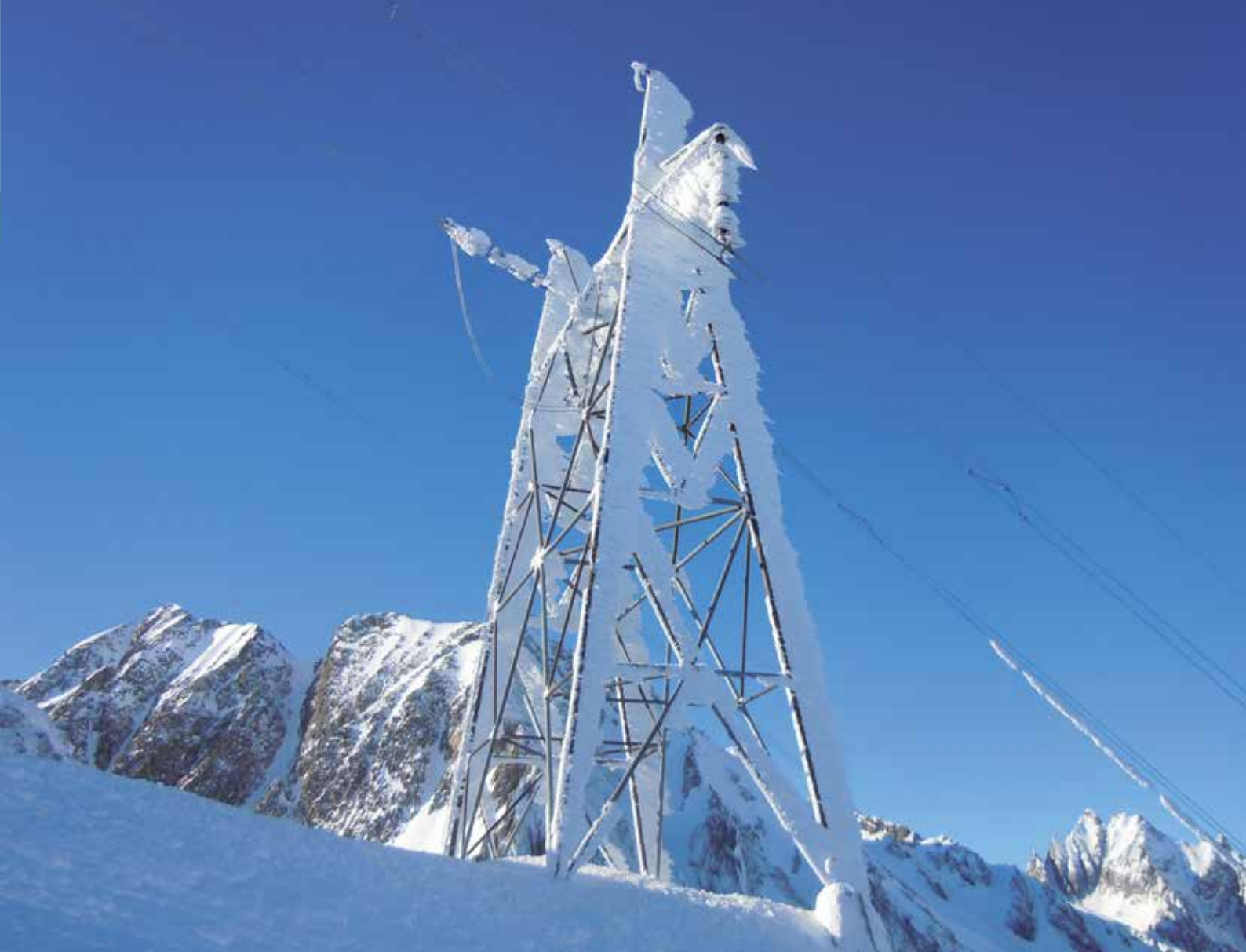
Starker Eisansatz an einem Masten der Lukmanierleitung nach dem Sturm «Andrea» im Januar 2012.
