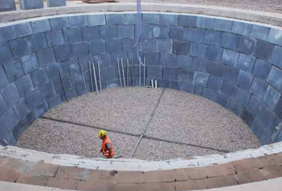
Thermischer Basaltspeicher zur Speicherung solarer Überschusswärme.
